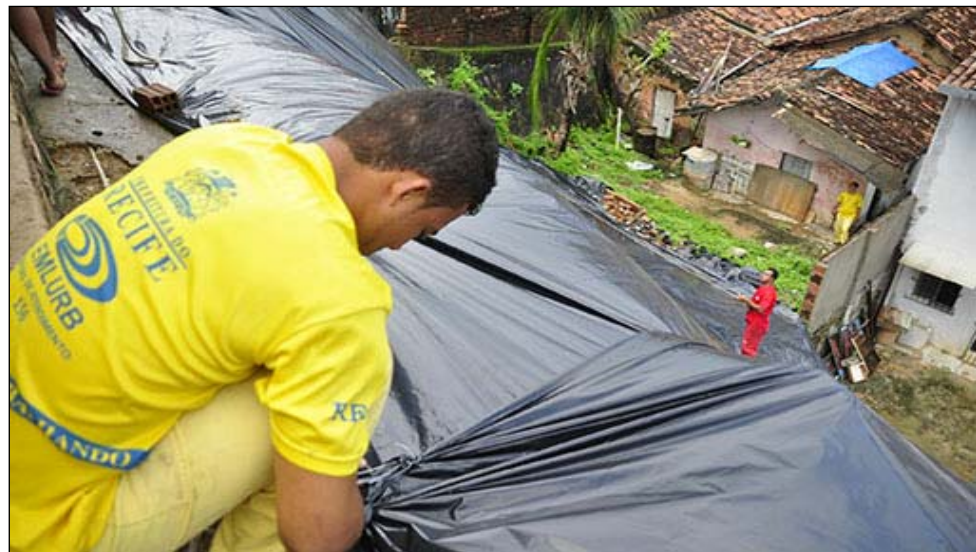
A Defesa Civil registrou 46 chamados para vistorias técnicas e colocação de lonas. Todas as ocorrências foram sem registro de vítimas.
