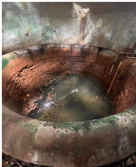
Figura 05: Estrutura de captação da Fonte Boacica, destinada ao abastecimento público, com presença de material terroso e sedimentos acumulados no fundo, folhas e material orgânico na água, além de sinais aparentes nas superfícies internas, indicando necessidade de avaliação das condições de limpeza e manutenção
