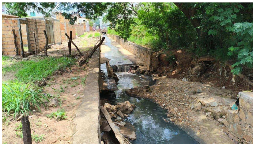
Imagem 06 – Trecho de canal de Drenagem urbano com parede danificada
