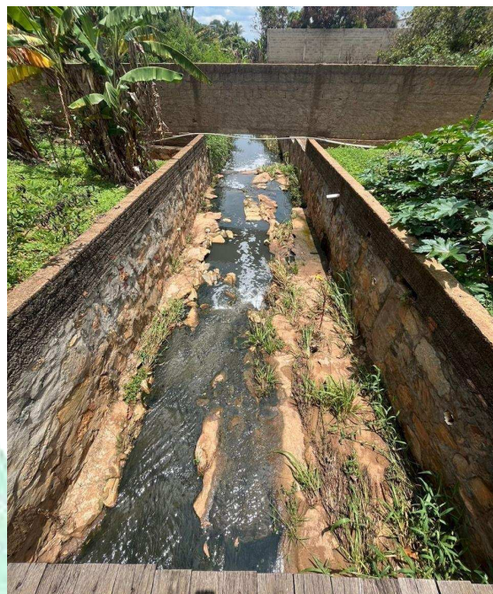
Imagem 03 – Trecho de canal de Drenagem urbano com piso e paredes danificadas
