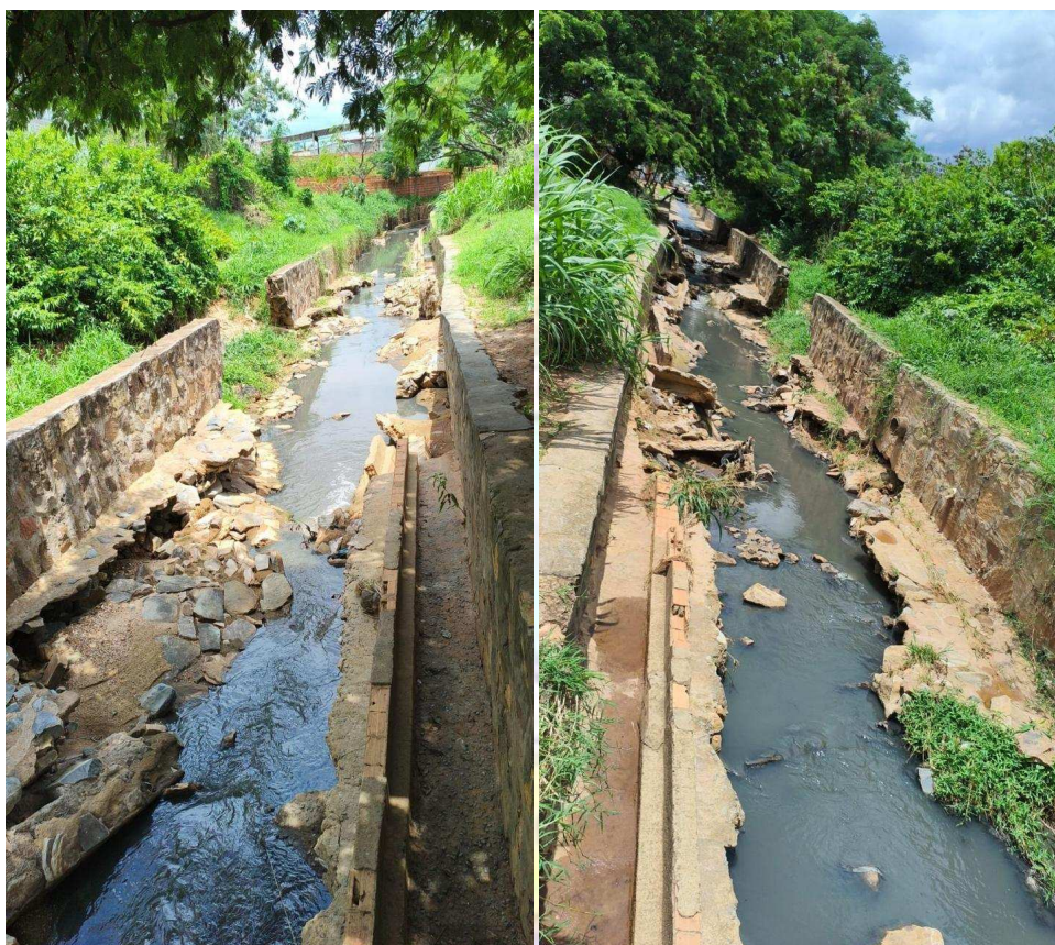
Imagem 05 – Trecho de canal de Drenagem urbano com parede, canaleta e piso danificados
