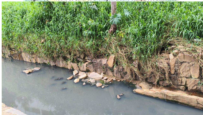
Imagem 07 – Trecho de canal de Drenagem urbano com parede e pisos danificados
