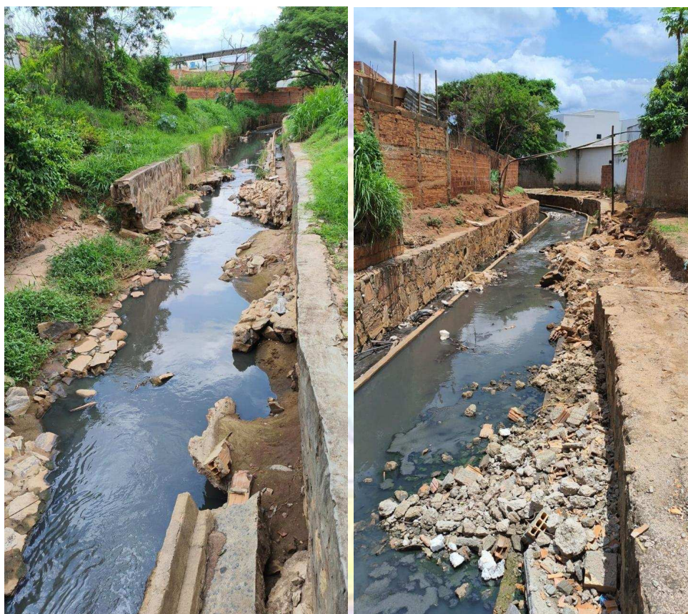
Imagem 10 – Trechos de canal de Drenagem urbano com parede, canaleta e piso danificados
