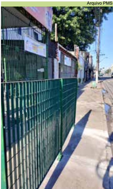
Chumbamento de guarda-corpo em frente à Creche Comunitária Amigos
