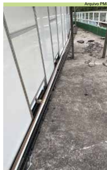
Instalação hidráulica nas barracas da Ilha Diana
