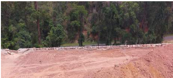
Imagem 03 – Vista do muro que incide na APP, por outro ângulo
