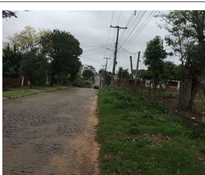
Figura 83: Inexistência de calçada
