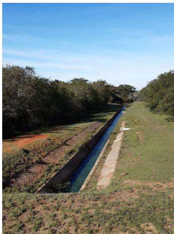
Figura 123 – Emissário no SES Freeway.
